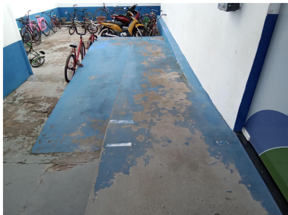
Rampa de acesso sem o corrimão
