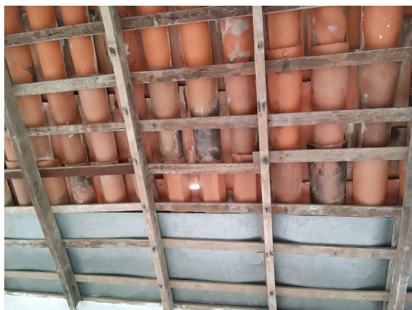
Tenha quebrada com goteiras
