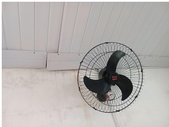
Goteiras próximas ao ventilador
