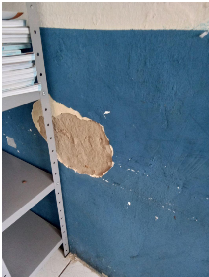
Parede com falha na pintura
