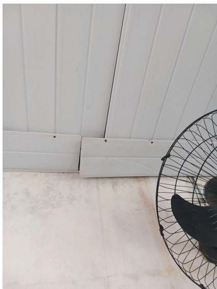
Forro danificado com goteira
