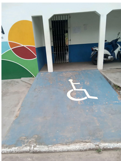
Rampa de acesso sem o corrimão
