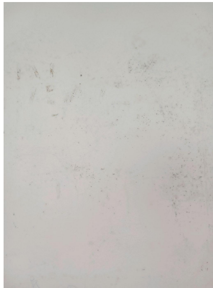
Paredes com mofo
