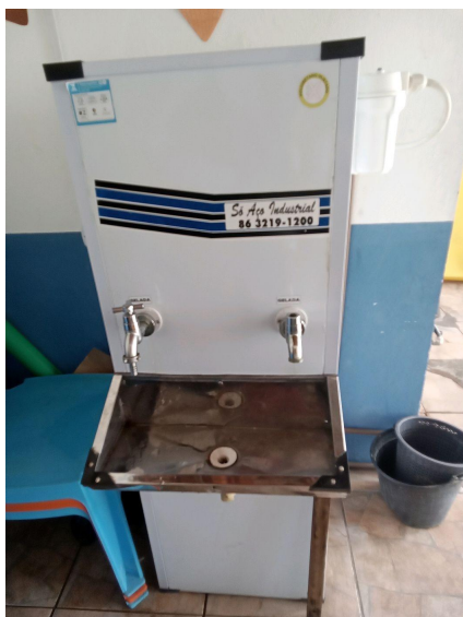
Torneira do bebedouro quebrada
